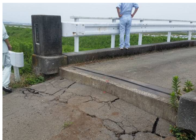
図 2 被災状況写真 2
