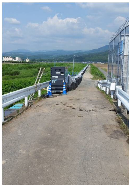
図 1 被災状況写真 1
