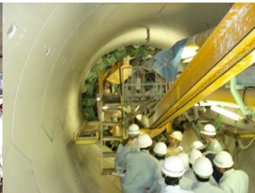
「外環状線 共同溝内の状況」（福岡市）
